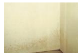
Stockflecken im unteren Wandbereich
