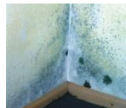
Boden-, Wandecke mit Schimmel
