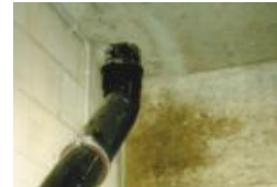
Aussenwand mit Feuchtigkeit und Schimmel
