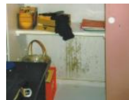
Schimmel an Schrankrückwand
